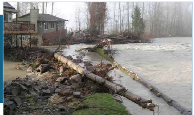
Ruptura del dique del río Tolt, enero de 2009
