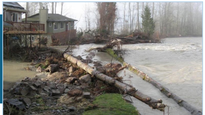
Ruptura del dique del río Tolt, enero de 2009
