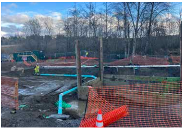
Las cuadrillas despejan y nivelan las zonas de trabajo antes de la construcción a fin de almacenar materiales y hacer espacio para la construcción.
