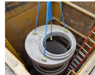
Las cuadrillas instalan un registro de alcantarillado donde se conectan dos tuberías.
