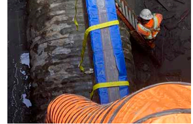
Los conductos de ventilación hacen circular aire fresco para el personal de las cuadrillas que trabajan bajo tierra.
