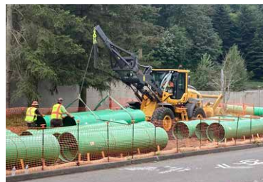
Se instalará una tubería de 32 pulgadas cerca del sendero I-90 en Mercer Island.
