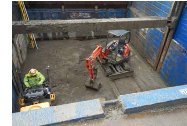
Una unidad de control de olores en SE 35th PI neutralizará los olores donde se unen dos tuberías.
