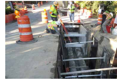
今年工作人員已完成在SE 22nd St安裝新污水總管的工作。
